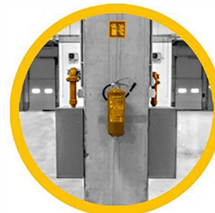
SISTEMAS CONTRA INCENDIOS
